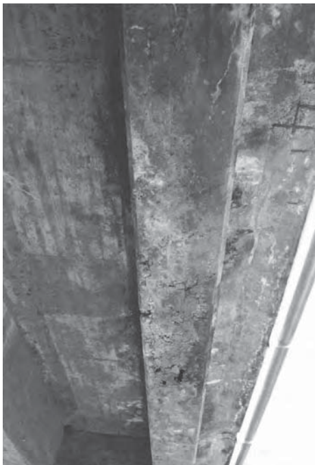
桁やはね出し部の錆鉄筋
