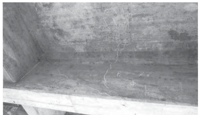
床版や桁のひび割れ
