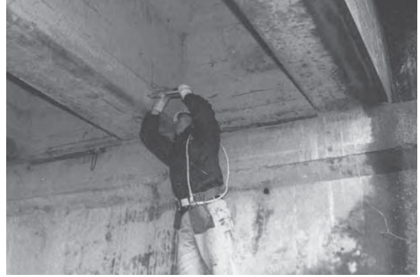
コンクリート強度を確認する (シュミットハンマーによる調査状況)
